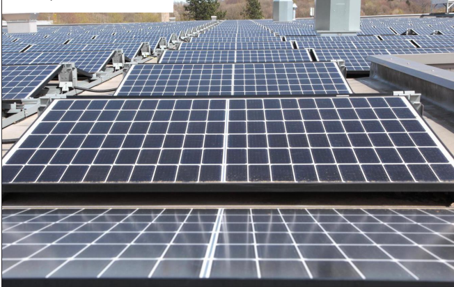
Photovoltaikanlage auf 1.800 qm Dachfläche.
